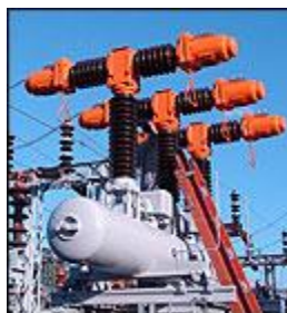
Figura 13 – Disjuntor a ar comprimido
